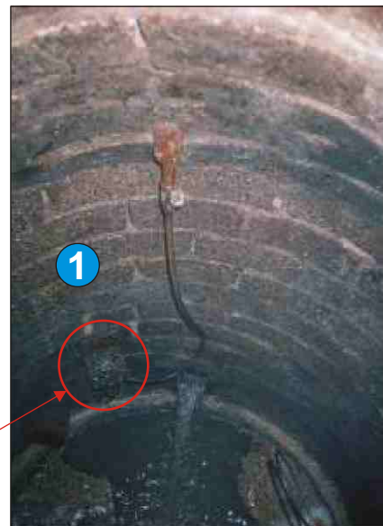
1. Il problema - Pareti aggredite chimicamente con conseguente infiltrazione...
